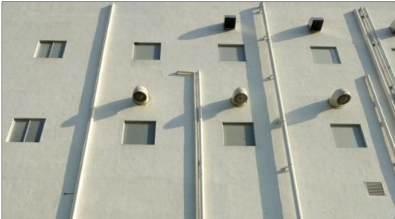
图 3-2 车间换气排气筒
