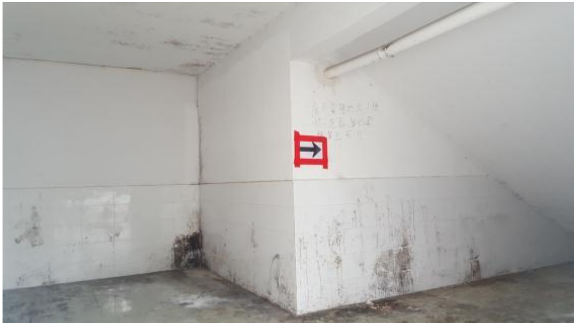
26 号厂房一般固废临时储存场所
