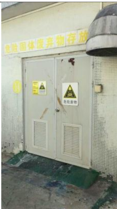
危险固废存放-近照
