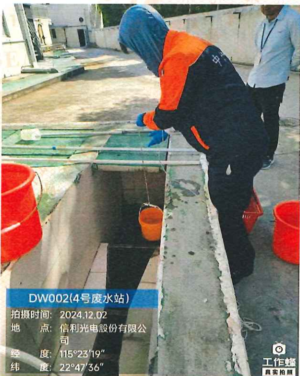
DW002（4号废水站）
